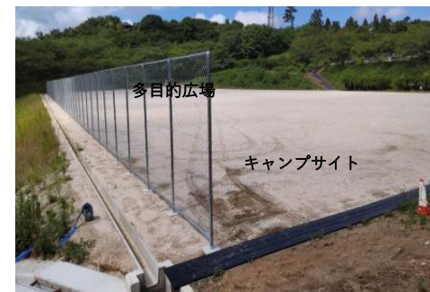
造成状況 R6.6月5日撮影
